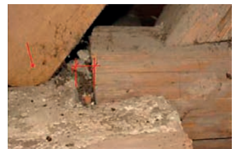
Kippendes Gesims und auf dem Gesims aufstehender Aufschiebling, exempl. f. d. Großteil des Dachstuhles
