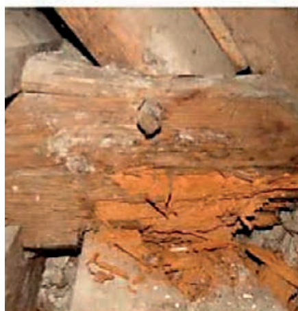
Durch Fäulnis geschädigter Deckenbalkenkopf sowie die äußere Mauerschwelle
