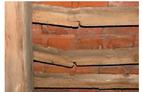
Ungenügende Lattenstöße, gilt exemplarisch
